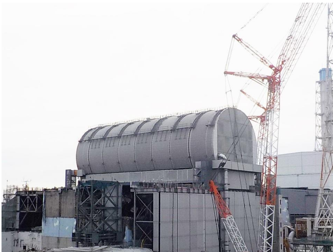
完成した燃料取り出し用カバー（出典:東京電力ホールディングス）
