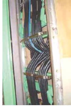
燃料交換機ケーブル
