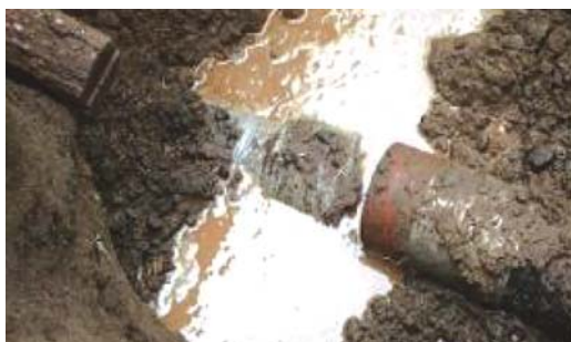
消火系配管の破損状況
