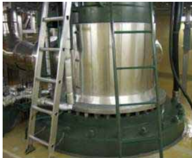
非常用炉心冷却ポンプ
