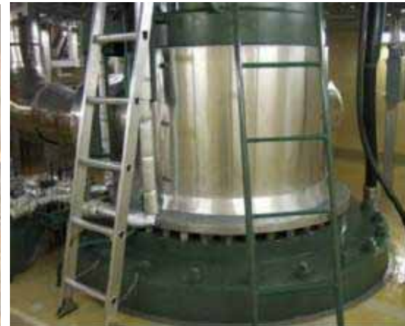
残留熱除去系 ポンプ
