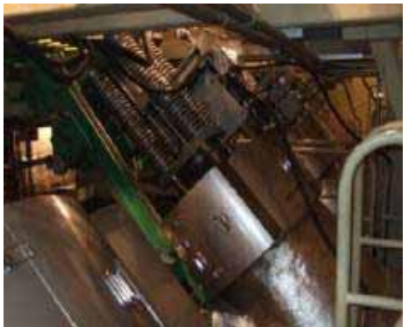
主蒸気隔離弁
