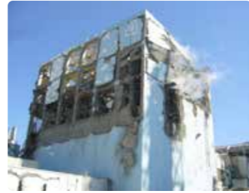
水素爆発を起こした原子炉建屋 (4号機) (写真提供: 東京電力HD(株)) Unit 4 Reactor Building after hydrogen explosion (Photo credit: TEPCO HD)
