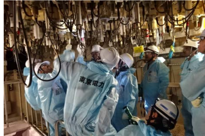
福島第二原子力発電所 4号機炉心底部(CRDM)
