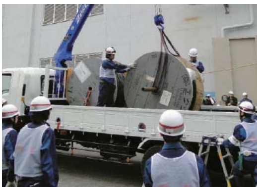
電源ケーブル
