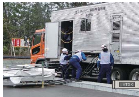
空冷式ガスタービン発電機車(4500kVA)
