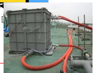
海水循環型浄化装置
