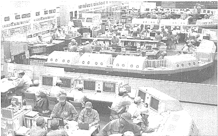
日本原燃六ヶ所再処理工場の中央制御室
