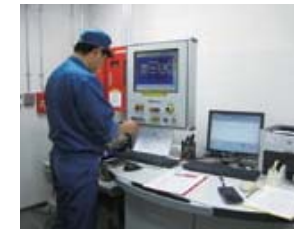
制御室コントロールパネル
